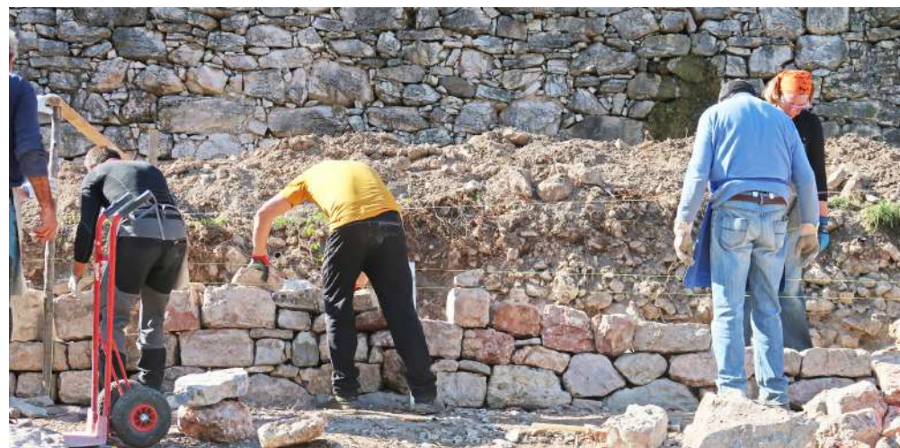
Fig. 41 - Nella foto sono illustrati due muri. Il muro sotto è in corso di realizzazione e come visibile le pietre di paramento sono posate senza l'uso di rinalzi (zeppe) inseriti dall'esterno. Come è possibile notare, il muro sopra, già esistente, era stato costruito con molte scaglie, diverse delle quali inserite da davanti che rendono più facile lo scalzamento delle stesse.
