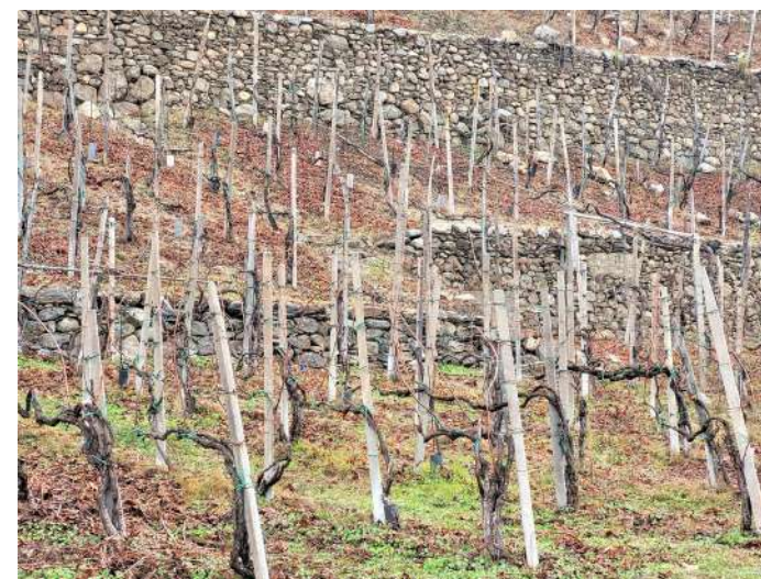
Fig. 4 - Muro di contenimento a regola d'arte Val Brembana
