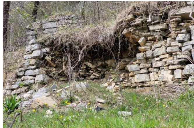
Fig. 20 - Crollo muro e scollegamento verticale Corna
