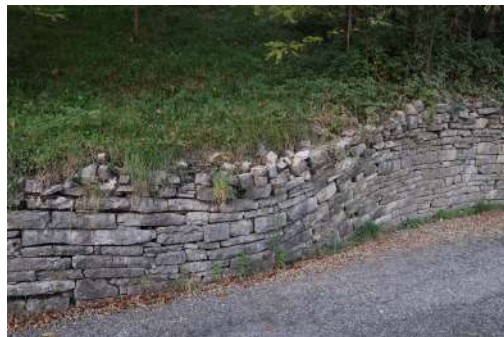
Fig. 14 - Muro deformato in seguito a un cedimento del terreno nelle vicinanze dopo gli scavi per la costruzione di una villa. Il muro ben costruito si deforma essendo costituito da diversi elementi, ma si adatta alla nuova configurazione senza crollare.
