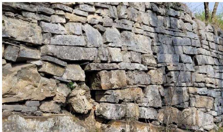
Fig. 17 - Esempio di spanciamiento Corna
