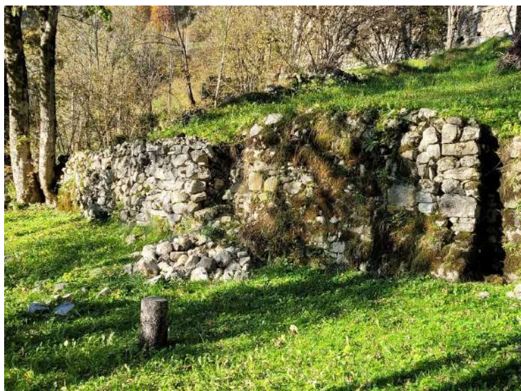
Fig. 15 - Esempio di spanciamiento Corna
