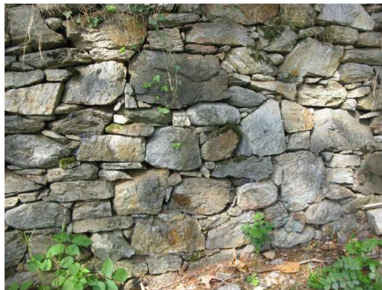
Figura 9 - paramento murario composto pressoché esclusivamente di rocce metamorfiche, anche di diversa origine: micascisti, quarziti, paragneiss, ortogneiss, anfiboliti, marmi, sia con elementi di foggia tabulare e/o a spigoli vivi, sia con elementi informi o arrotondati - loc. Prasomaso, Tresivio. (immagine: Alfredo Dell'Agosto)
