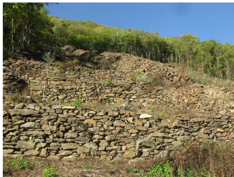
Figura 10 - antichi terrazzamenti formati prevalentemente da elementi di micascisti filladici alterati, dell'Austroalpino (ex Formazione della Punta di Pietra Rossa), con sporadici isolati alloctoni di origine glaciale - vigne degli Homodei, versante retico, Sernio. (immagine: Alfredo Dell'Agosto)
