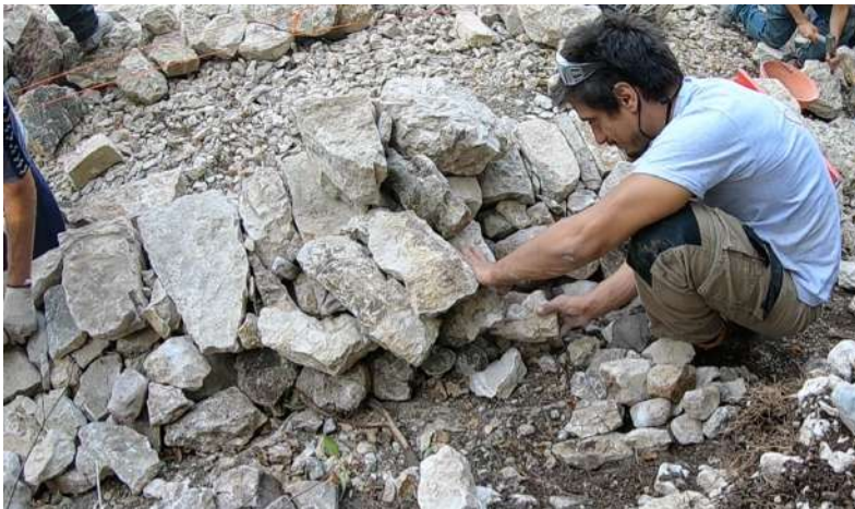
Fig. 38 – Un insegnante durante un corso che sostituisce una pietra nel retro del muro (paramento interno) che non era stata posata correttamente.
