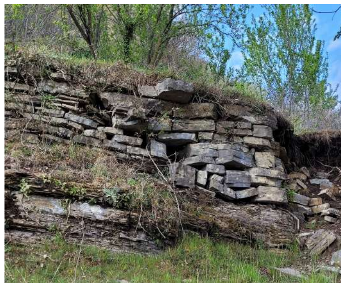
Fig. 16 - Esempio di spanciamiento Corna
