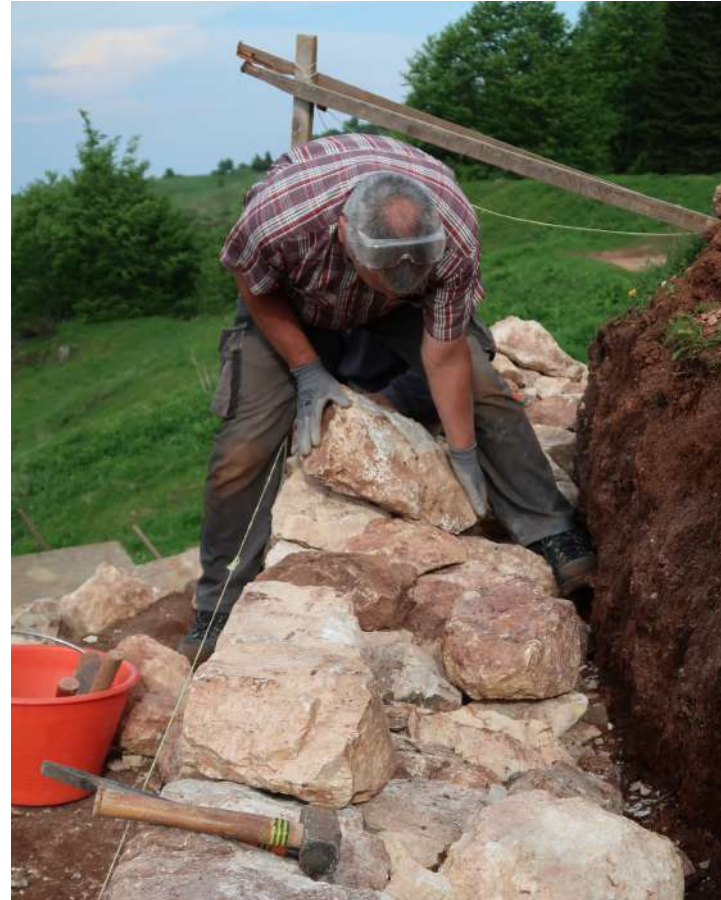
Fig. 1 - La posa di un concio durante un corso di costruzione di muri di contenimento in pietra a secco
