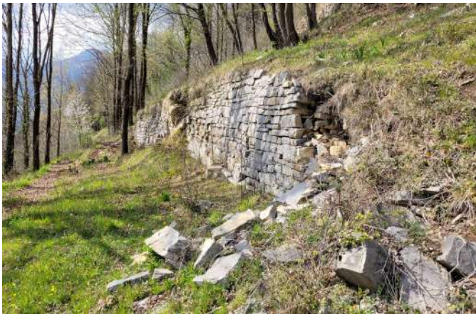
Fig. 19 - Crollo muro e scollegamento verticale Corna
