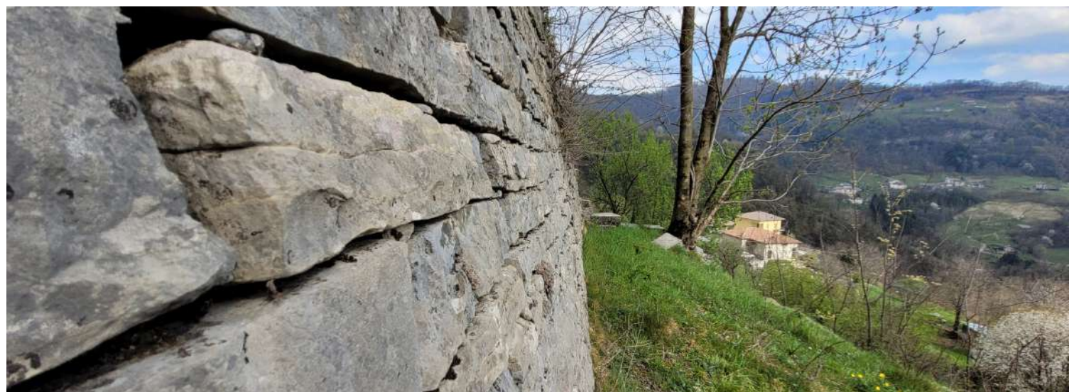
Fig. 5 - Muro di contenimento a regola d'arte Val Brembana
